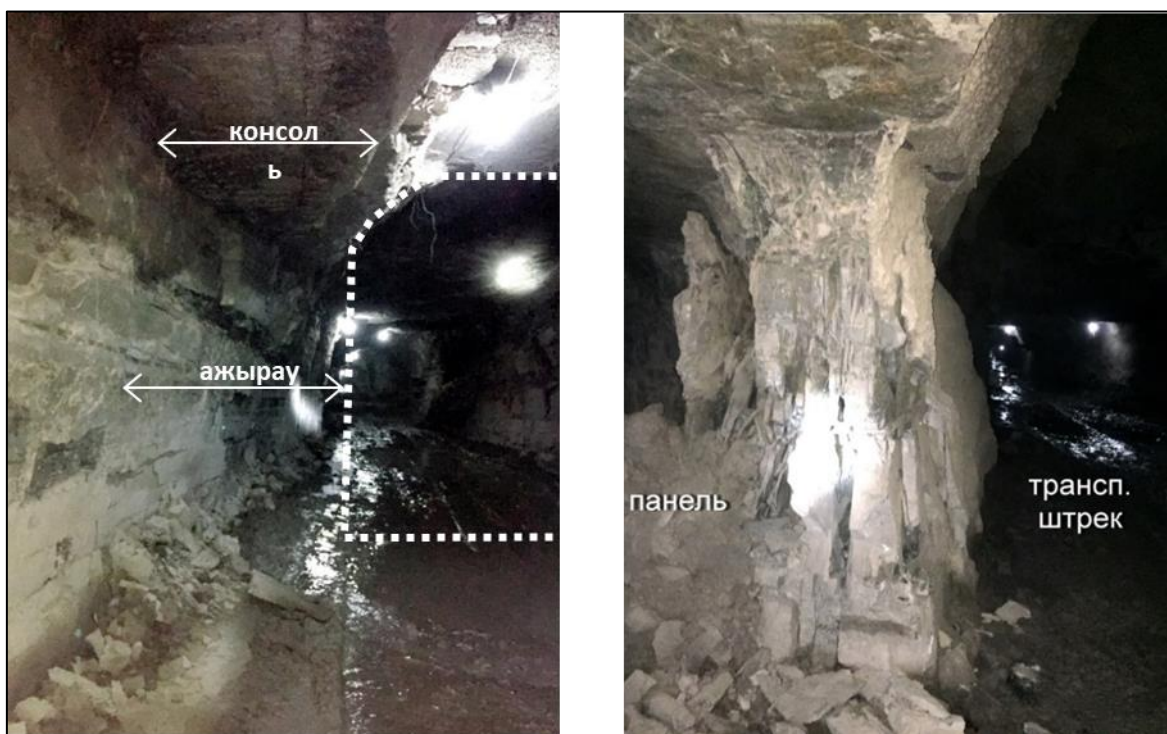
Рисунок 1 – Определение характера разрушения целиков
